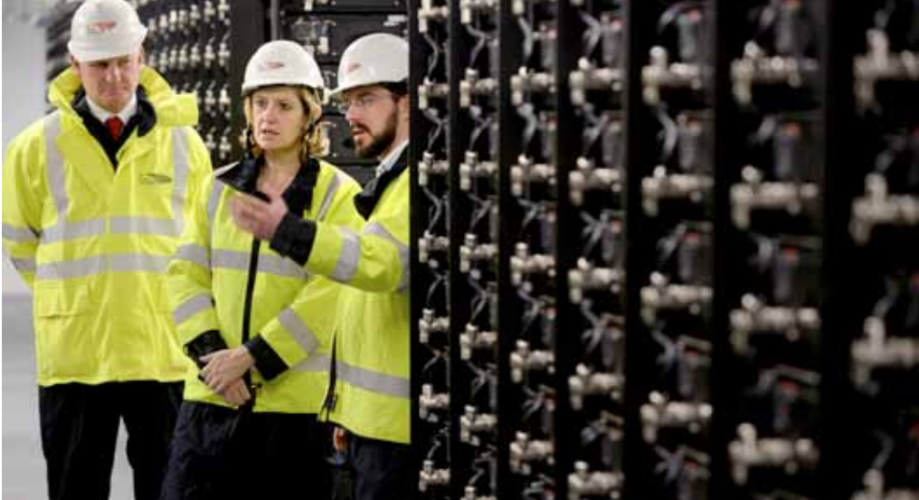
Yunicos-Batteriespeicher der Wemag in Schwerin, Foto Yunicos
