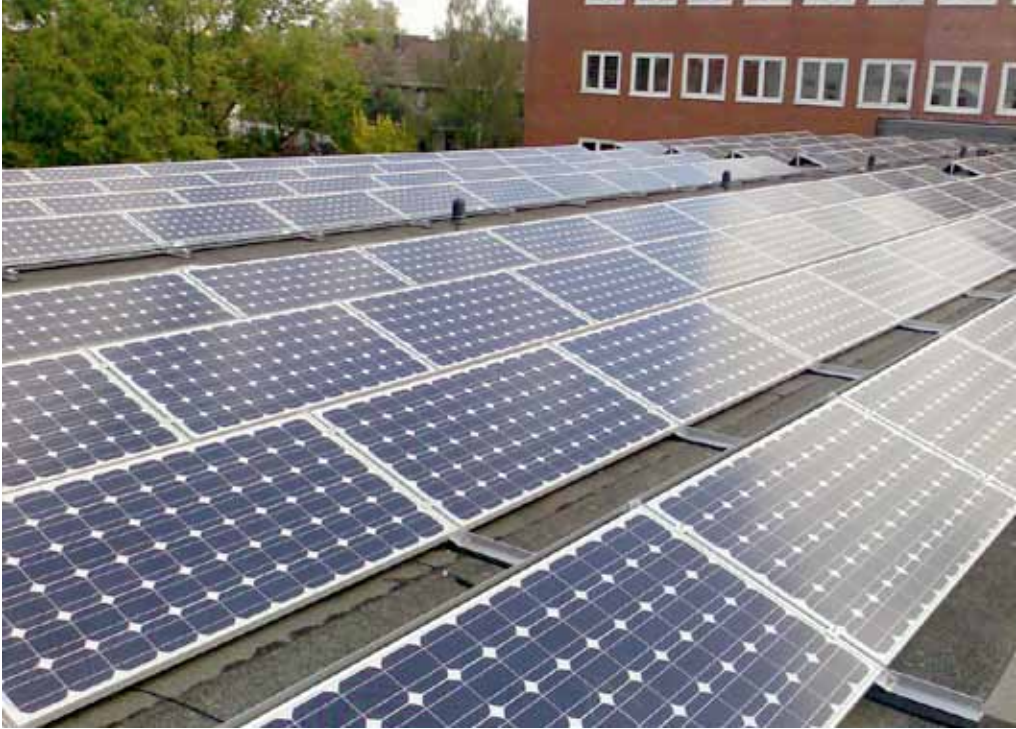
PV-Dachfläche auf einer Schule Hildesheim, Foto: Landkreis Hildesheim/Flickr
